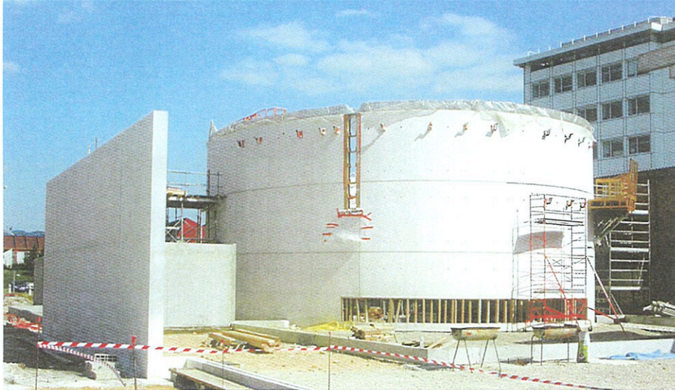
L'amphithéâtre du centre de conférence L'Oréal à Aulnay-sous-Bois est réalisé en béton blanc auto-plaçant, coulé à la benne
